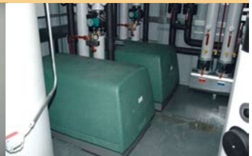
Blick ins Innenleben der Energiezentrale: Zwei redundante Wärmepumpen
