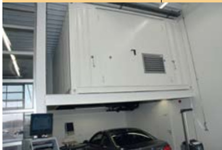
Die Energiezentrale: Als Container-Modul im Werkstattbereich „eingeschoben“
